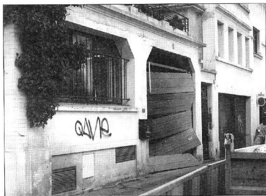
Attentat contre la secte Moon. Le 30 janvier, une forte explosion a pulvérisé le portail du siège de la secte, 9 bis rue de Châtillon. Les riverains s'en sont émus. Notamment les autres habitants de l'immeuble qui ont tenu à faire savoir qu'ils n'avaient rien de commun avec leur dangereux voisin... (photo : J. K. A.)
